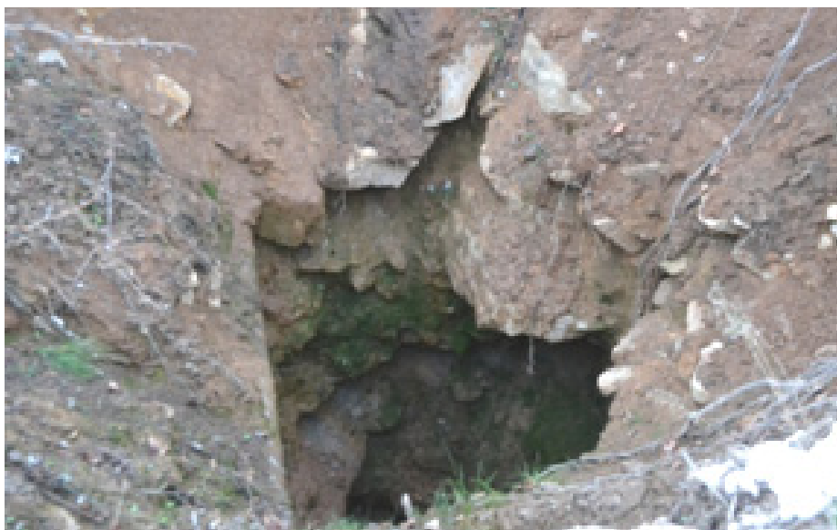
Провал в лесном массиве (в 250 м на северо-восток от зданий бывшего Ставропольского ЛПХ, 2016 г., район Красновка).
